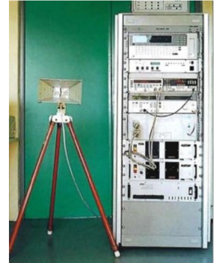
Baies de mesure RF
